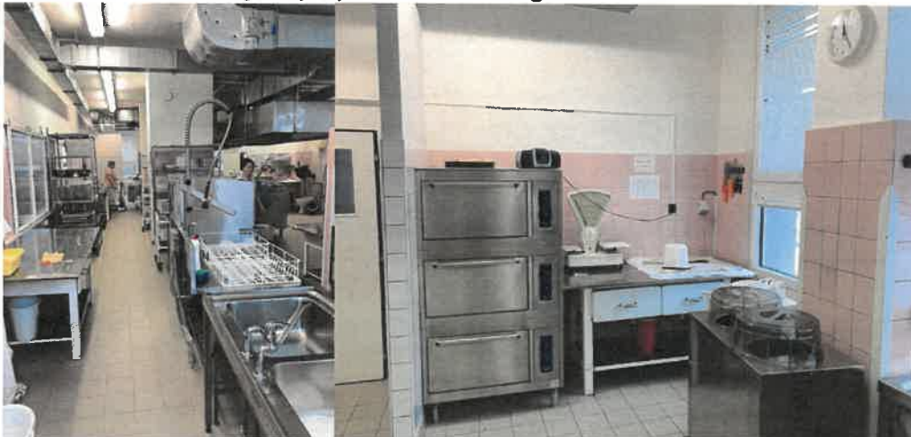
Obrázek č. 3-4 ukazuje myčky a troubu bez digestoří.
