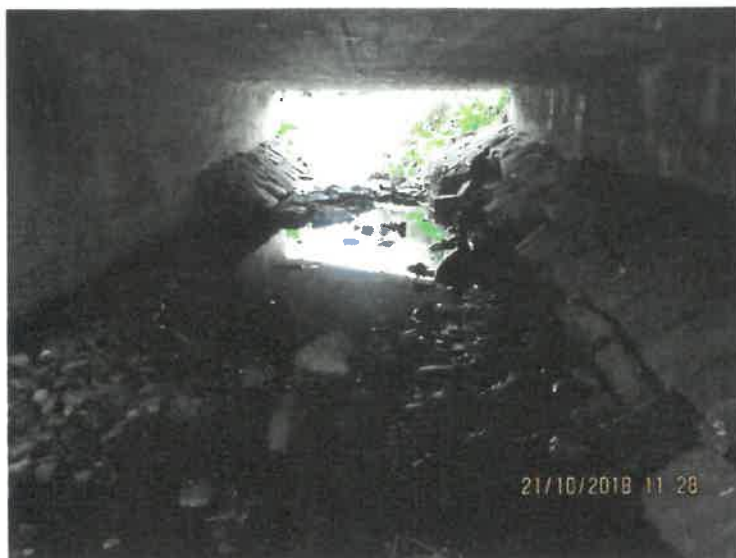
Rozplavená celá dlažba pod mostem.
