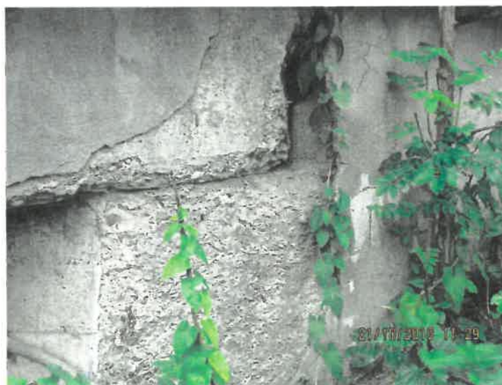
Potečené opěry z úložných prahů. Drolí se rohy úl.prahů.
