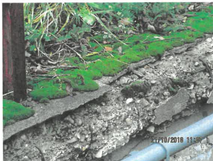
Odpadlý beton z římse. Drolící se římse.
