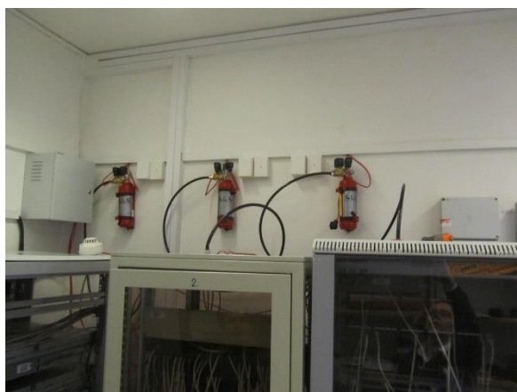
Obrázek 10: Instalovaný systém SHZ v serverovně
